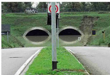
Sott'acqua Il sottopassaggio di via del Lazzaretto colmo d'acqua (Lapresse)
