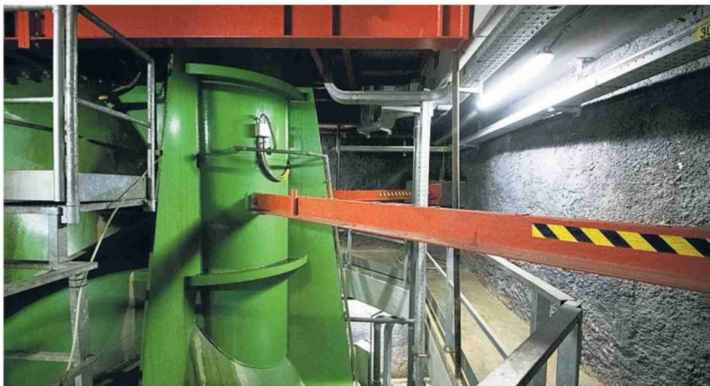
▲ Nel sottosuolo La turbina della centrale idroelettrica all'altezza di via Marconi
